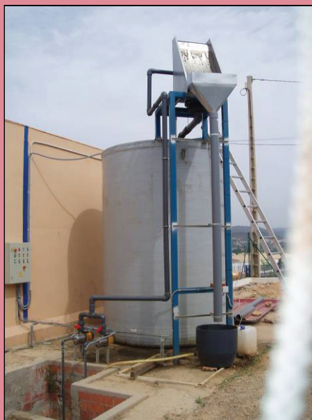
Instalación de tratamiento de vertido final: bombeo doble (1+1), tamizado fino y homogeneizador aireado
